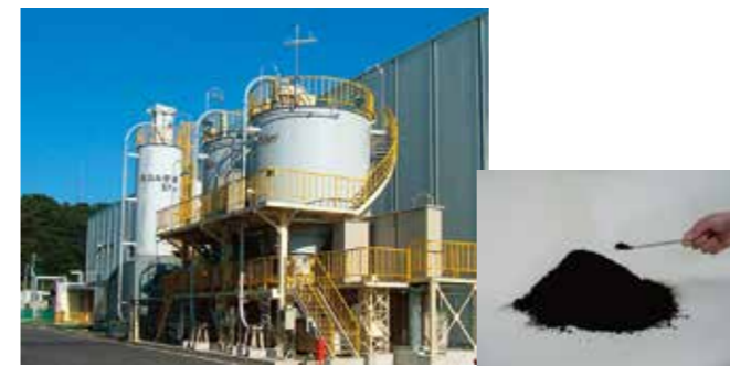
炭化燃料貯蔵設備
