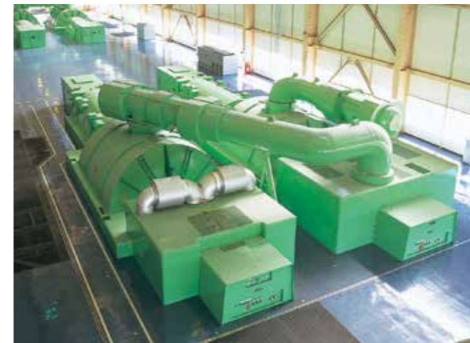
タービン・発電機
