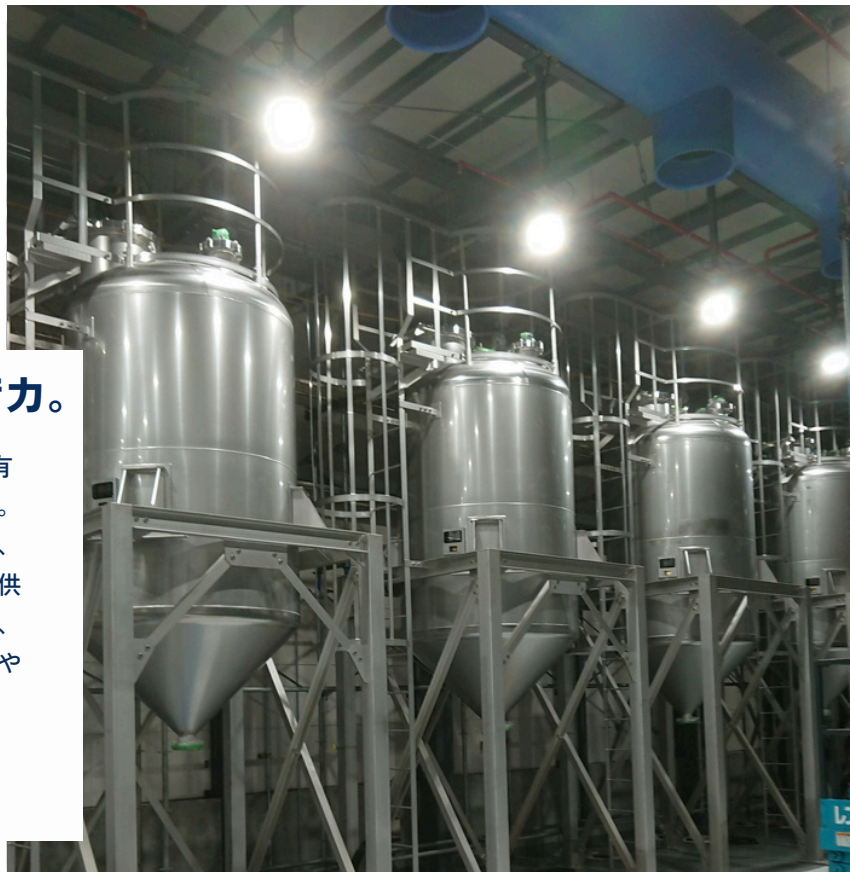
アルコールタンク
