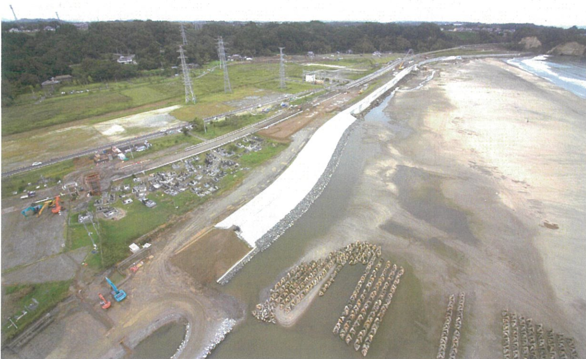
工事名:福島県 0417号 公共災害復旧(再復)工事(海岸) 工 期:平成27年3月16日～平成29年1月31日
