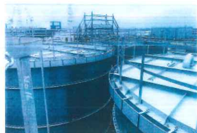
1F 汚染タンク廻り雨桶及び雨水集合テント
